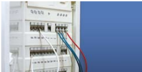
Der zentrale SCHRACK Multimedia Verteiler
